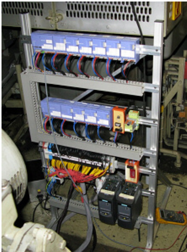
SPS und Frequenzumformer auf portabilem Gestell im Maschinenraum
