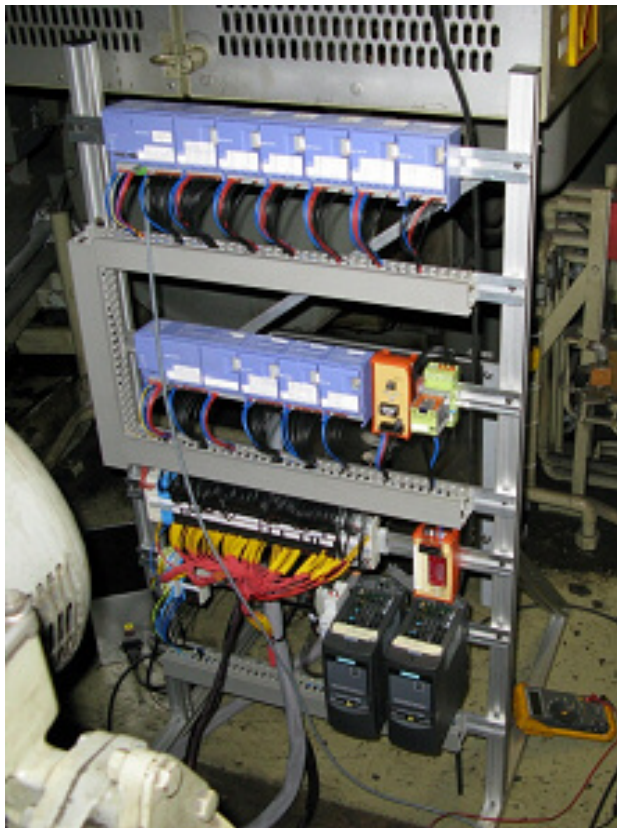
Automate programmable et convertisseur de fréquence dans la salle des machines
